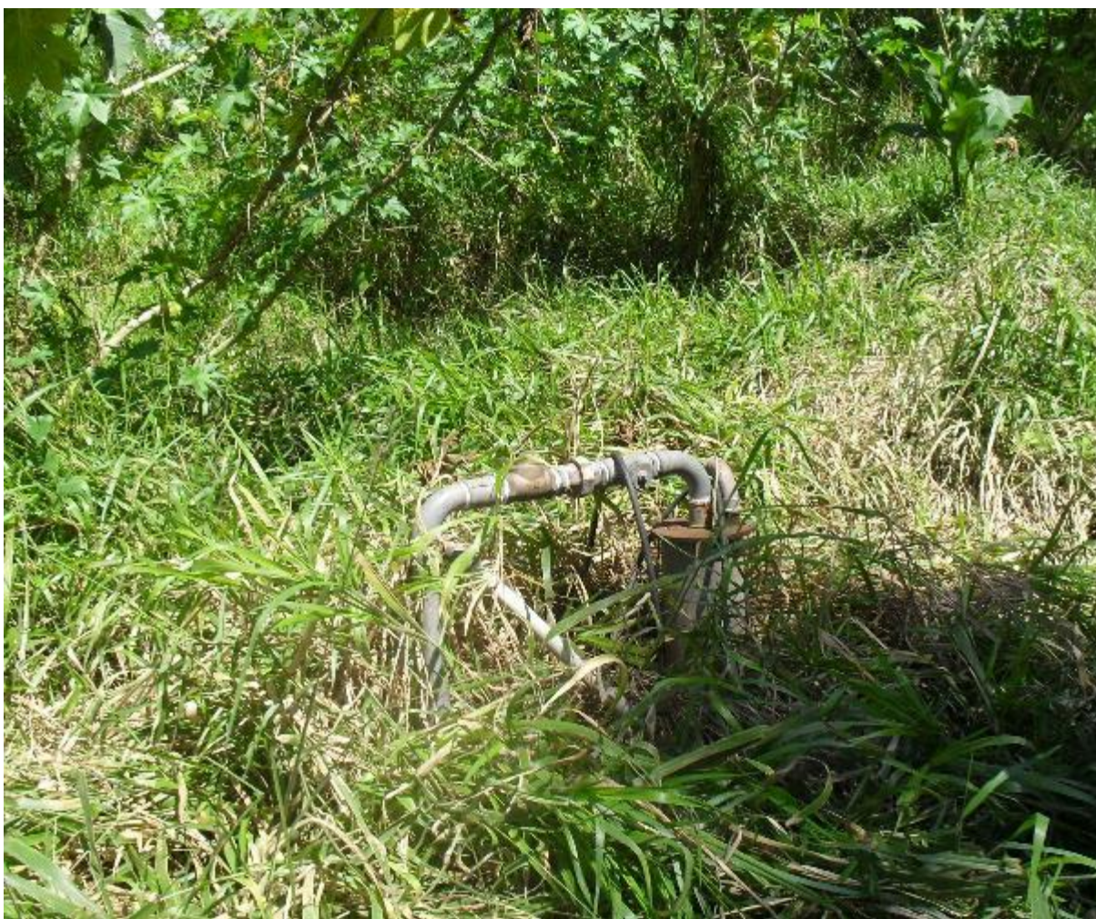
Figura 27. Poço Tubular Profundo Parque de Máquinas.
