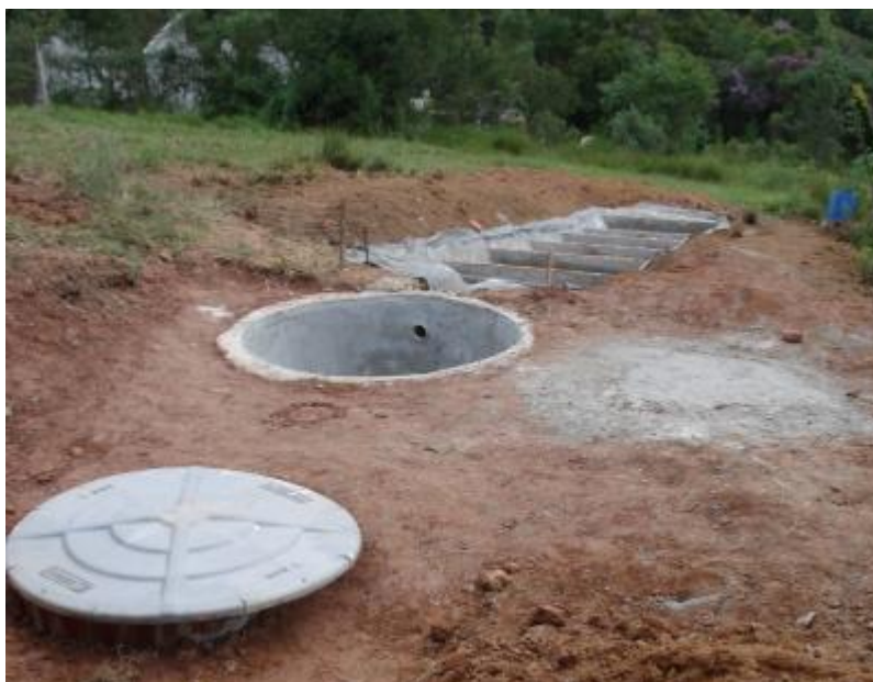
Figura 59. Fossa séptica e sumidouro em área rural.
