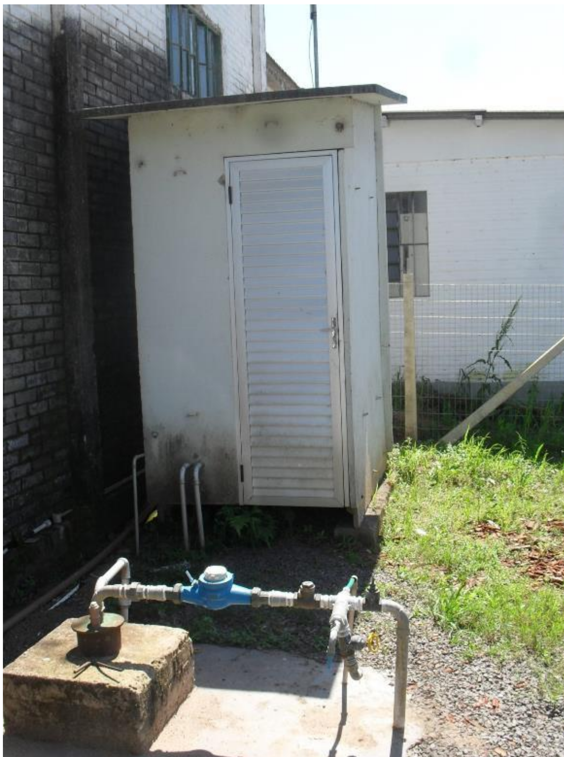
Figura 26. Poço Tubular profundo Berçário Industrial
