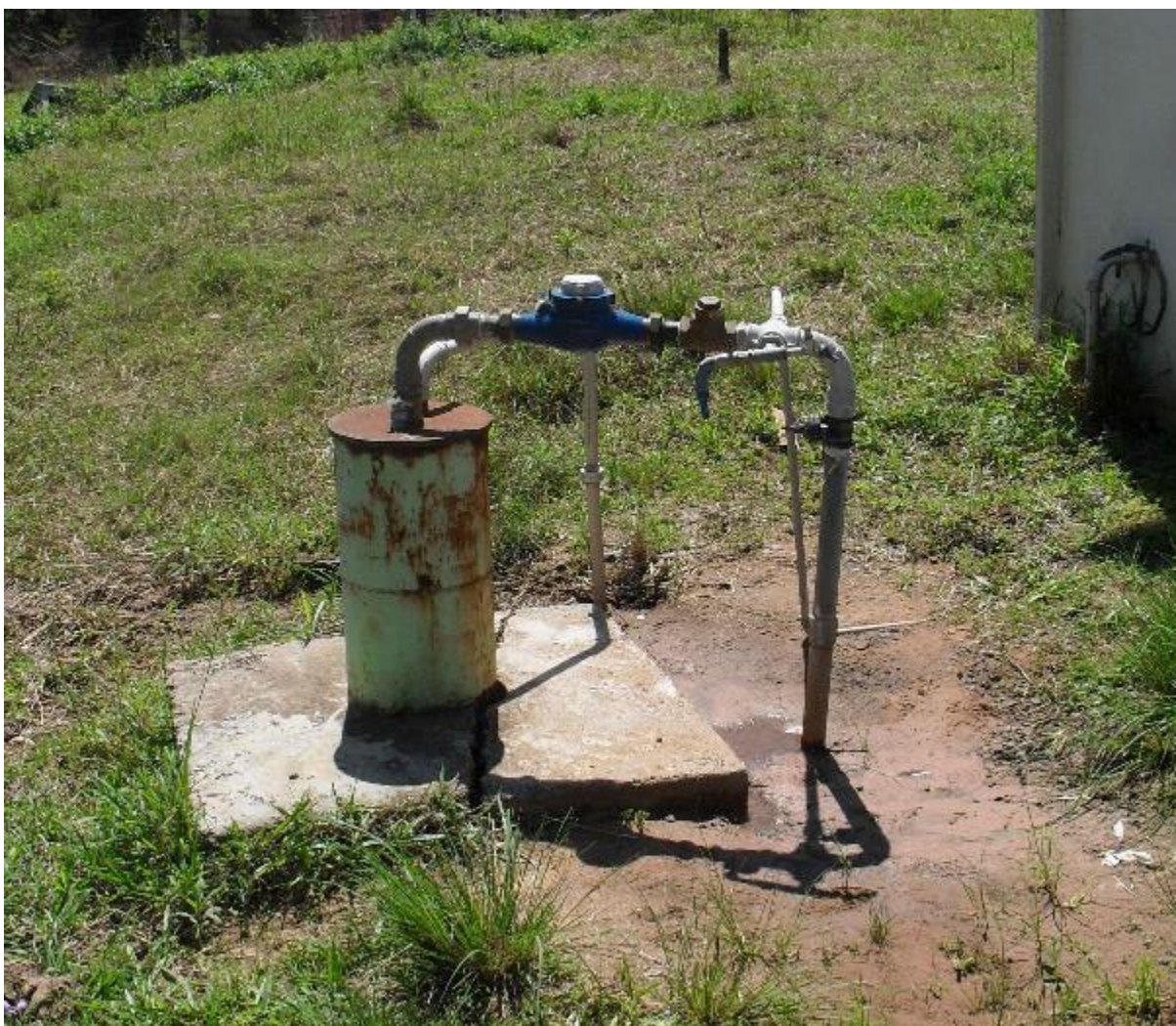
Figura 30. Poço Tubular profundo Ginásio
