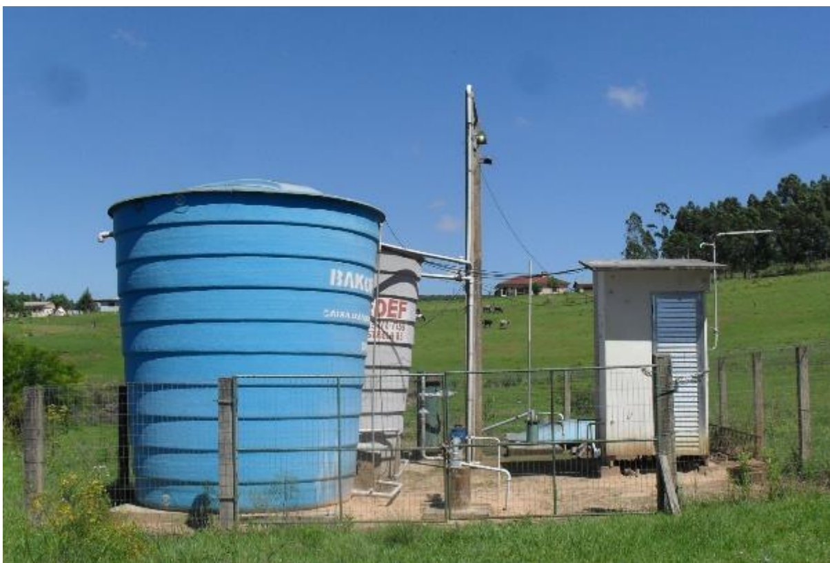
Figura 35. Sistema de Tratamento Élio Cardoso
