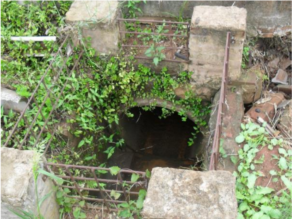
Figura 75. Duto de drenagem pluvial.
