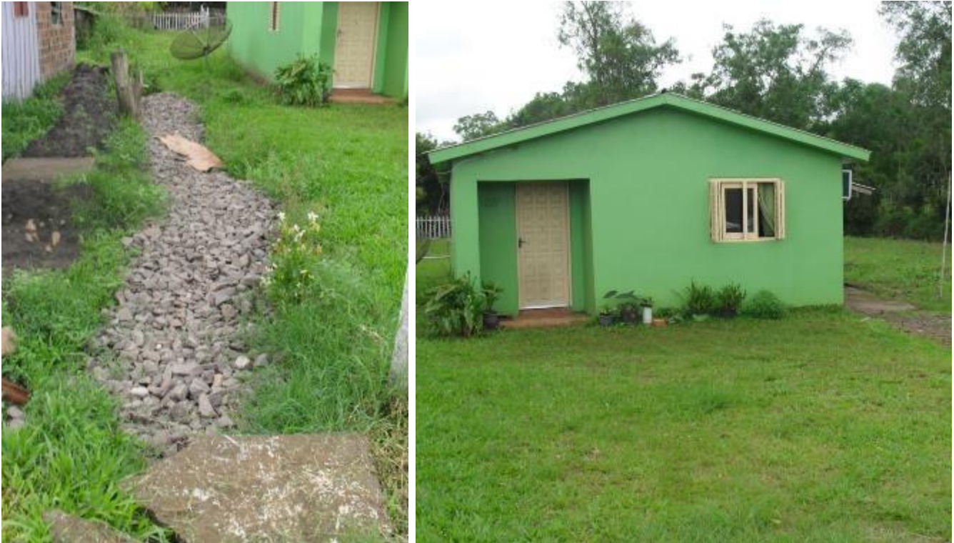
Figura 74. Dreno coberto por cascalho (à esquerda) e casa afetada pelos alagamentos (à direita).
