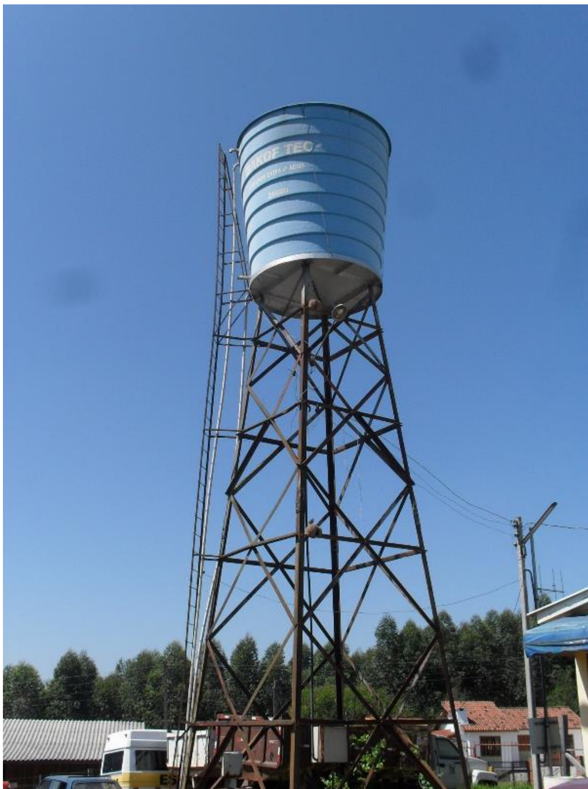
Figura 28. Reservatório Sistema Berçário.
